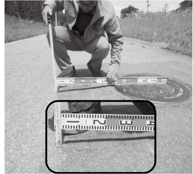
マンホールが路面より約7cm高く通行に支障
