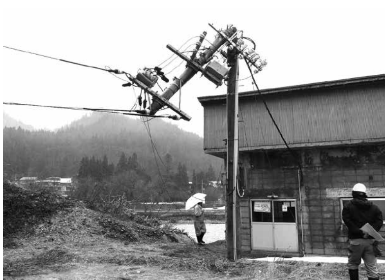
豪雪で倒木の被害を受けた受電電柱
