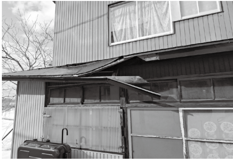
雪で破損した軒先
