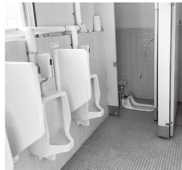
老朽化した役場庁舎トイレ
