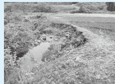
増水により浸食された護岸
