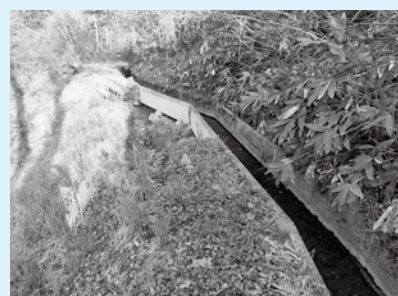
越水による用水路法面崩壊
