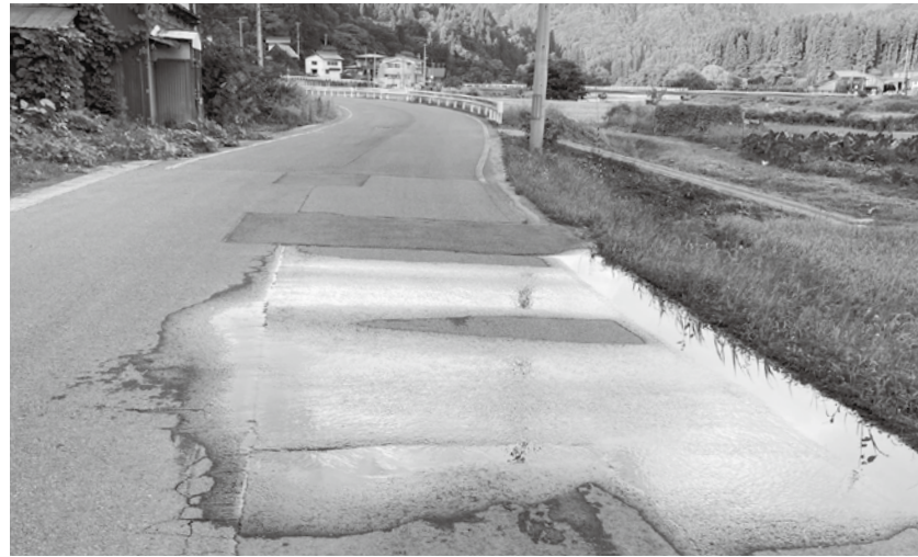
漏水している町道内山長尾線
