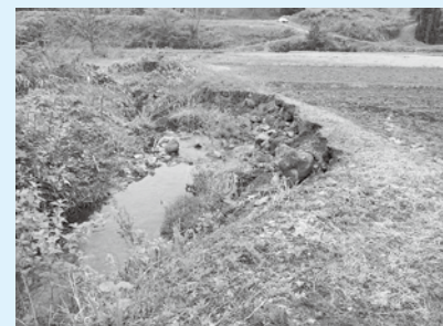
増水により浸食された護岸
