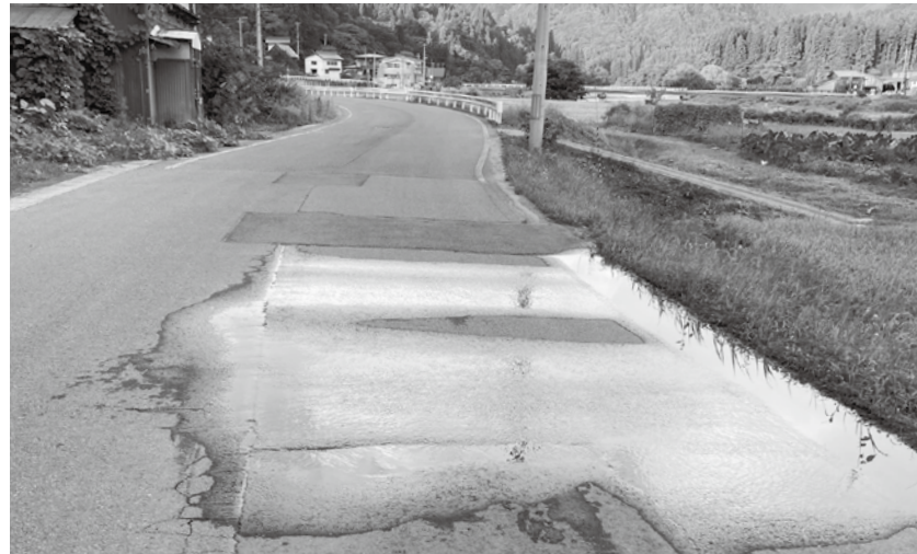
漏水している町道内山長尾線
