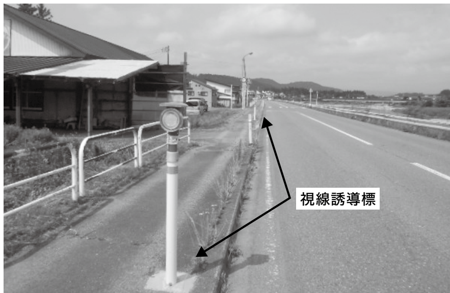
県道56号線に設置された視線誘導標
