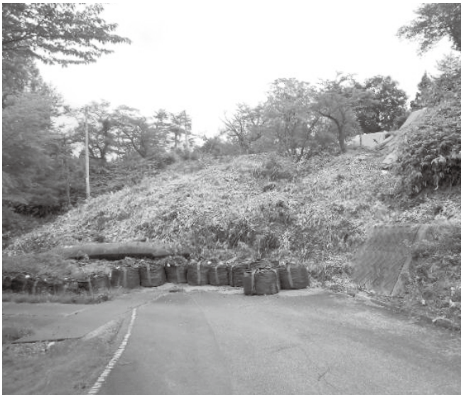
土砂が崩落した町道猿羽根山1号線
