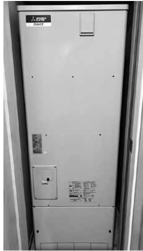
新しくなった給湯器
