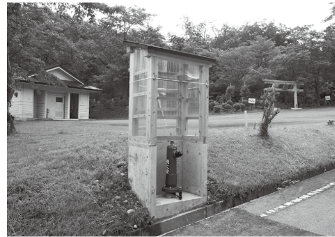
民俗資料館前に整備された消火栓
