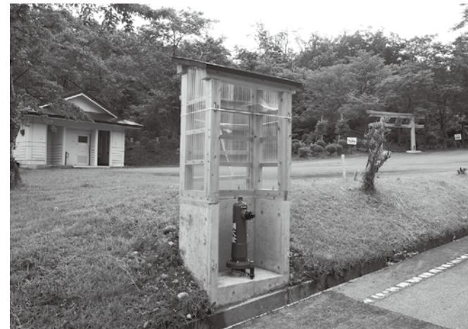
民俗資料館前に整備された消火栓
