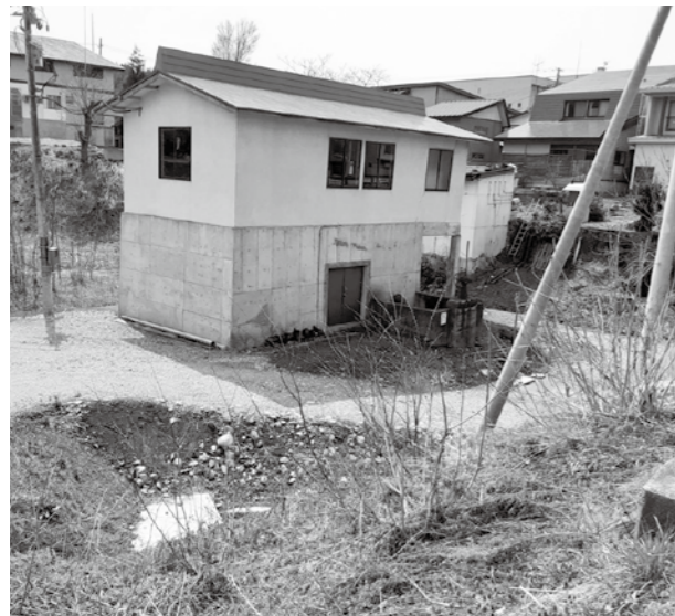
裏の山へ送水しているポンプ小屋
