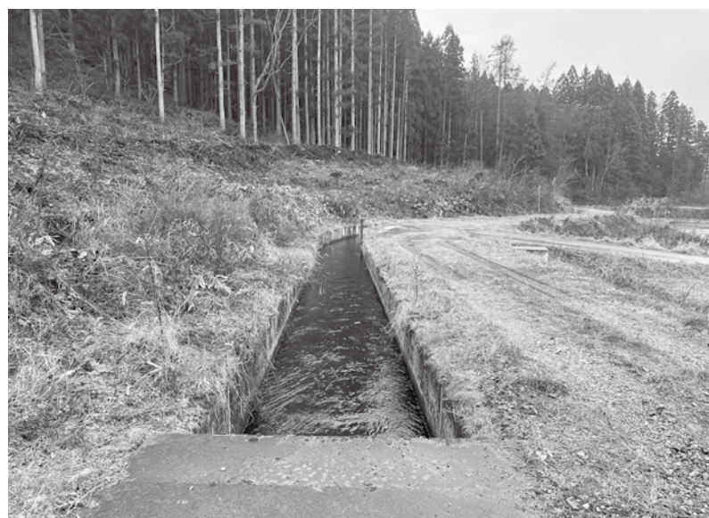
早期改修工事が望まれる大堰
