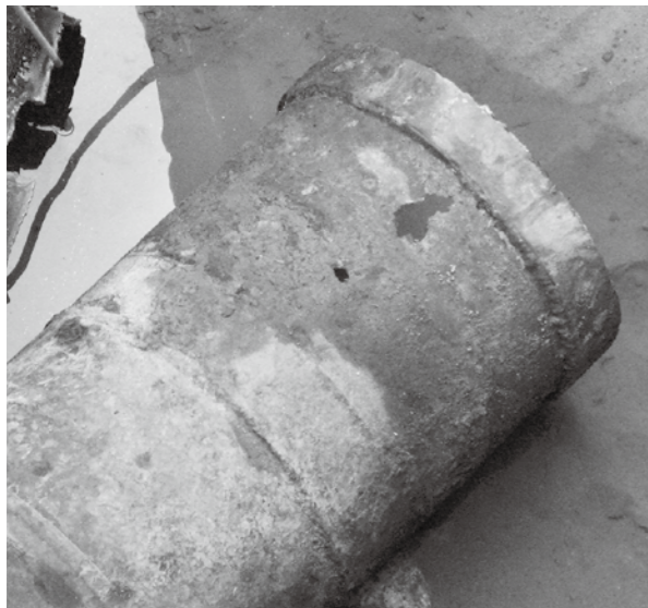
老朽化により破損した送水管
