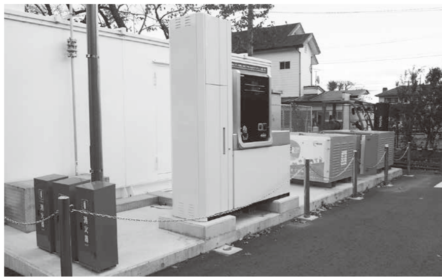
水素供給ネットワークを活用した施設（簡易水素ステーション） 福島県浪江町庁舎（令和4年11月研修）
