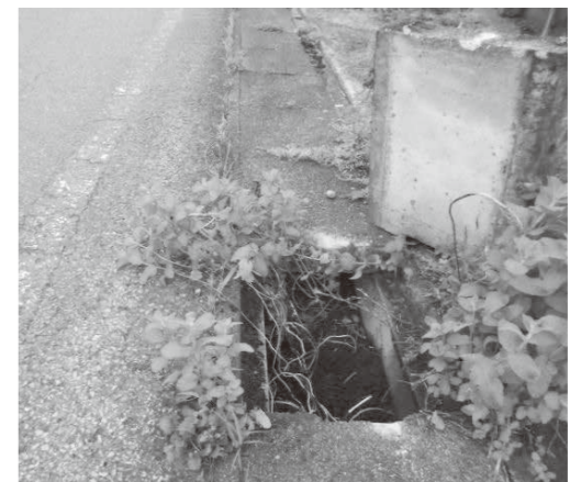
堆積土砂から雑草が伸びた町道側溝
