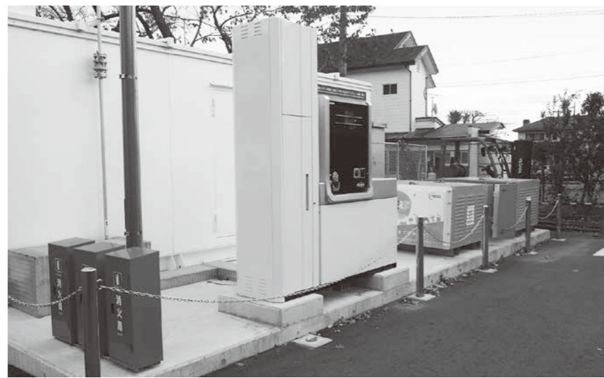
水素供給ネットワークを活用した施設（簡易水素ステーション） 福島県浪江町庁舎（令和4年11月研修）
