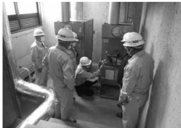
2基更新された灯油ボイラー（生涯学習センター）
