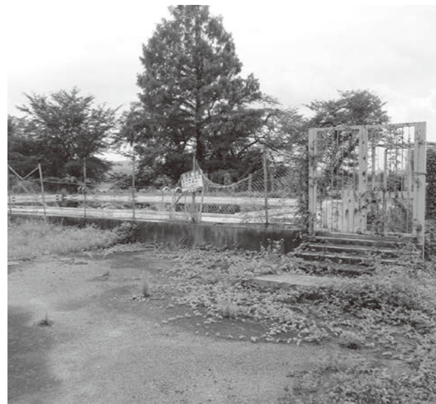
荒廃が進むプール
