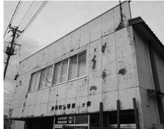
13号線から見る解体予定の老朽化した庁舎
