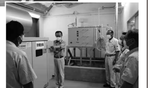
停電時稼働する自家発電設備(舟形町防災センター)
