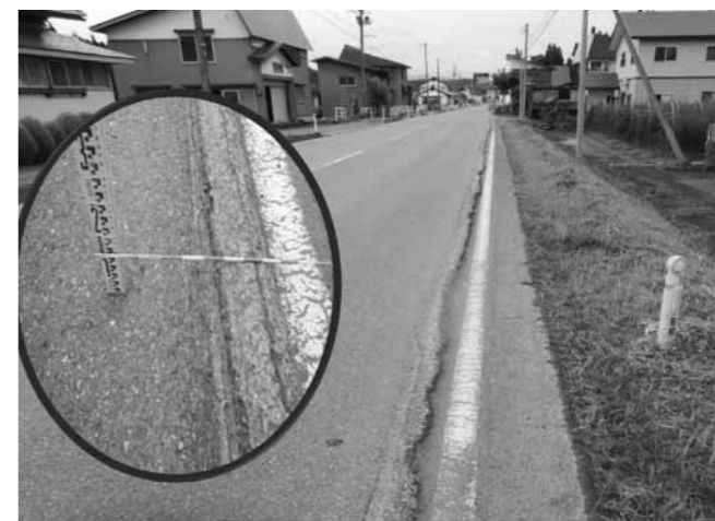
10cmの段差が生じている県道56号線(一の関地内)
