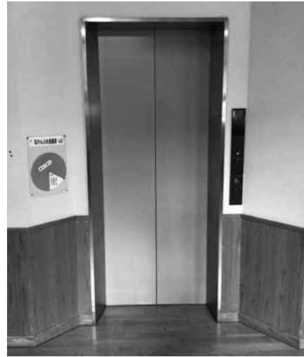
舟形小学校に設置済のエレベーター
