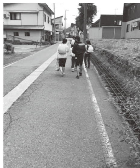
すき 隙間が大きく足が落ちる危険な鉄筋格子蓋
