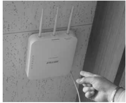
舟形小学校職員室に設置されているWi-Fiルーター
