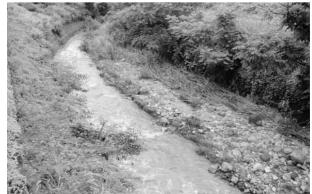
支障木、堆積土砂の撤去が必要な河川
