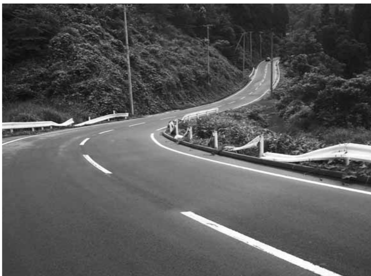
雪により破損したガードレール（舟形太郎野線）
