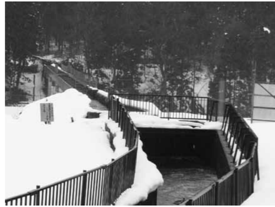
大雨時に氾濫の危険性が高い三光堰（紫山地内）
