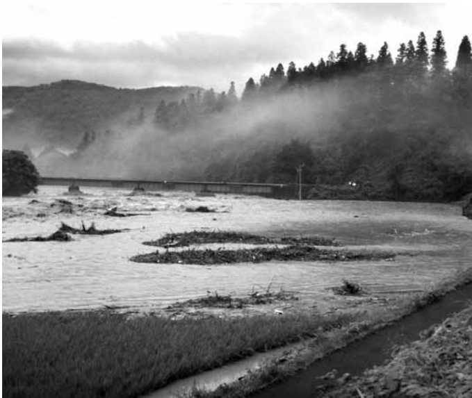
濁流に呑み込まれた水田(JR陸羽東線小国川第二橋梁 長尾地区)
