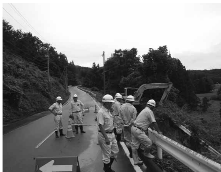
町道舟形太郎野線路肩崩落現場
