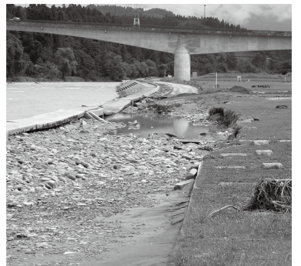
小国川の氾濫により決壊した十二河原公園迂回道路
