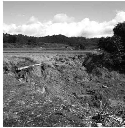
通行不能になった農道
