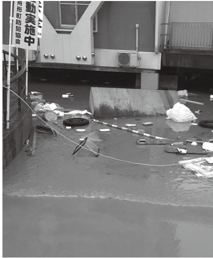
想定外の災害により冠水した 役場本庁舎地下ピロティ
