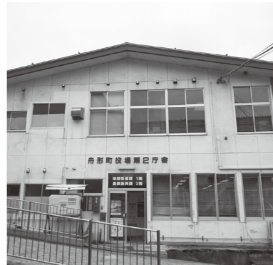
老朽化が著しい第2庁舎
