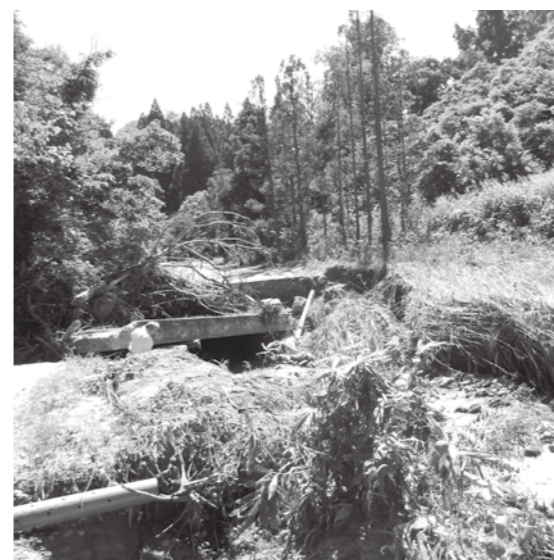
台風9号により流出した大持橋（沢内川）
