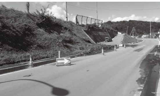
豪雨による法面崩落現場（旧堀内小下）
