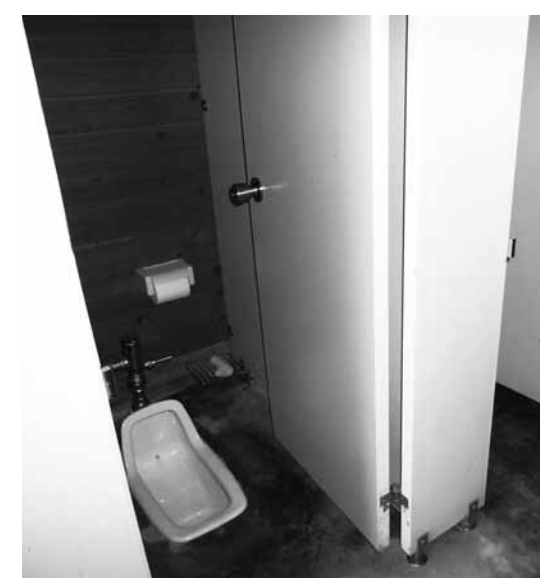
洋式への改修が待たれる河川公園トイレ
