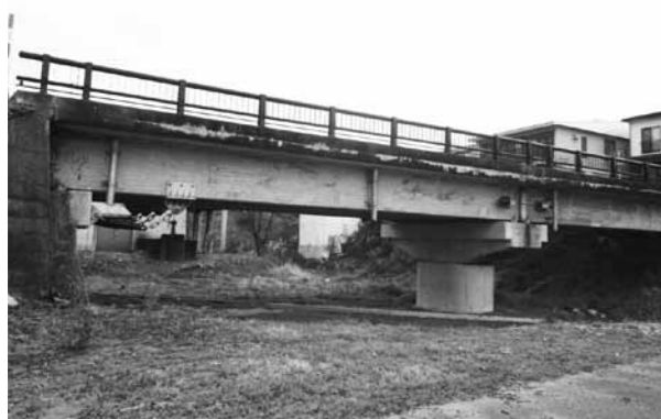
寺下地区の冠水の要因となる場所
