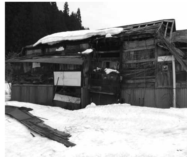
危険な空き家
