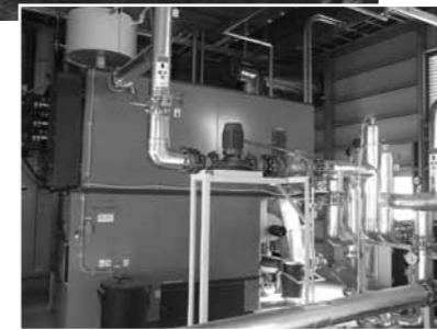
木質チップボイラー施設 (真室川温泉)
