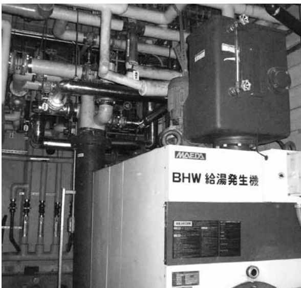
温泉の給湯設備
