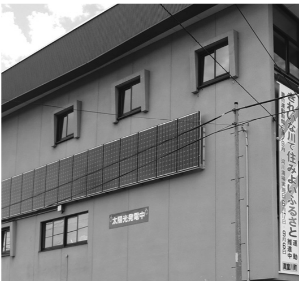
太陽光発電装置（真室川町役場）
