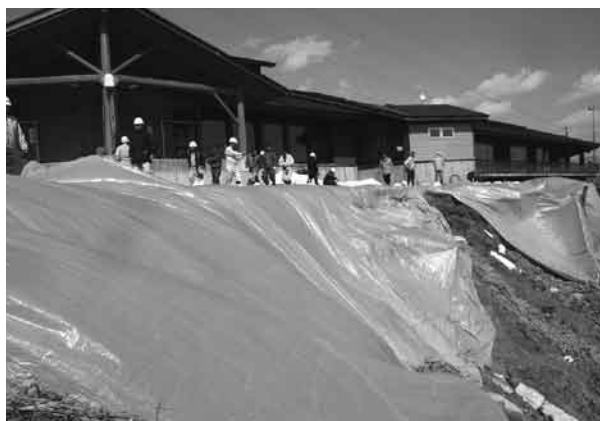
余震による崩落現場（若あゆ温泉）
