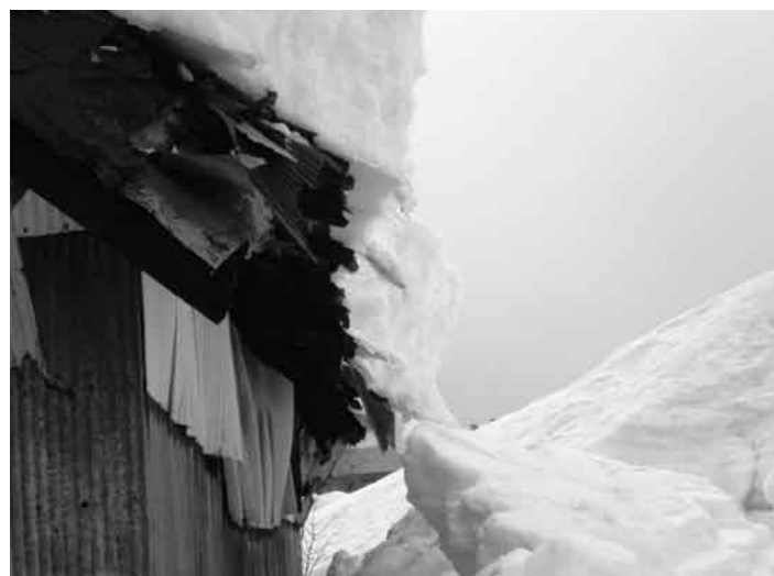
豪雪により軒下の破損
