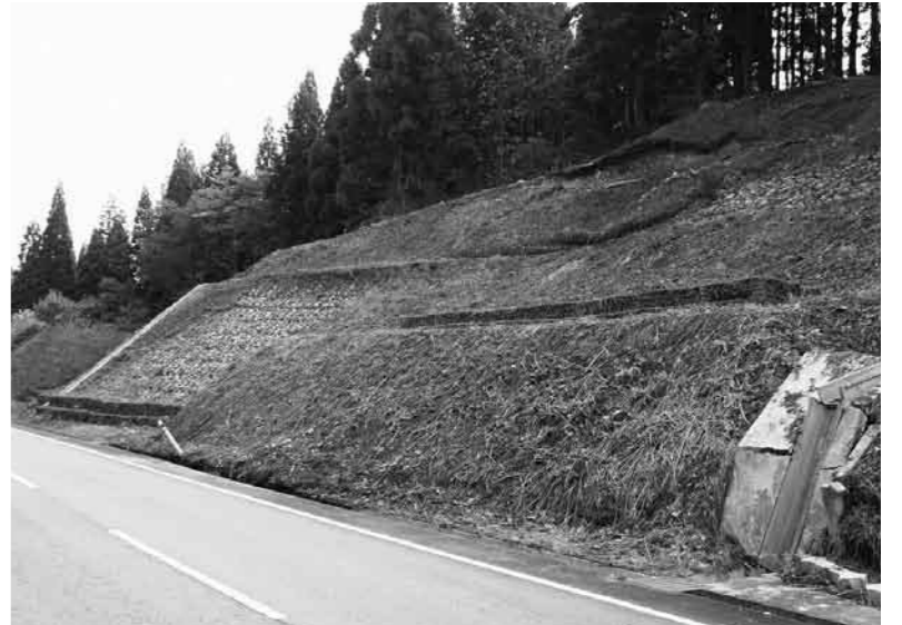
一の関若あゆ大平線崩壊現場
