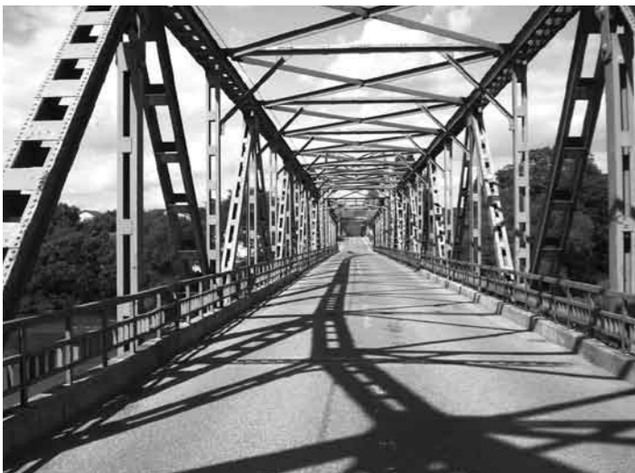
架け替えが待たれる堀内橋
