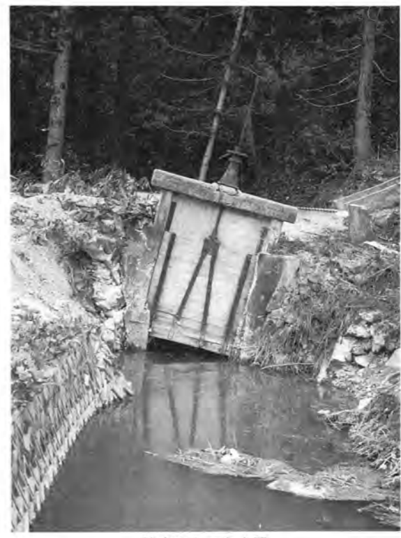
被害にあった水門
