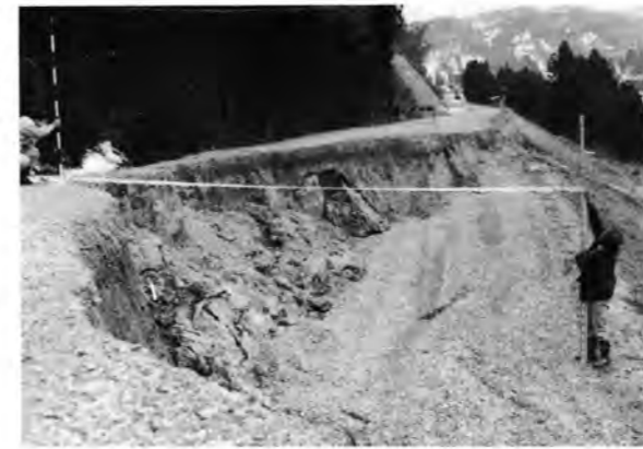
▲56年融雪災害により道路が寸断され通行不振となった。
