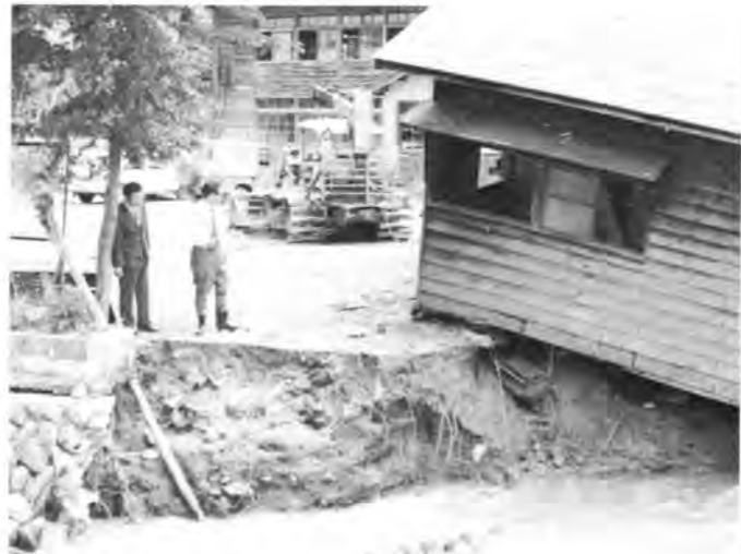
昭和51年8月6日水害のツメ跡。 災害復旧事業は、51、52年度と急ピッチに進められそのほとんどが完成した。
