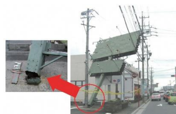
看板が倒壊した事例
