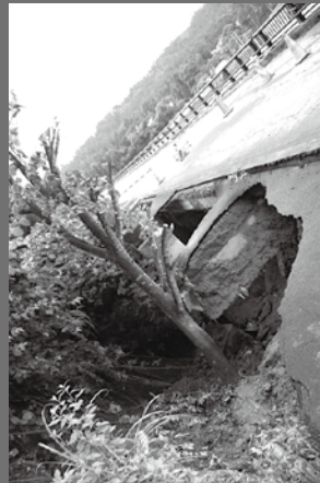
▲一の関大橋の橋台部の土砂流出
