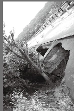
▲一の関大橋の橋台部の土砂流出
