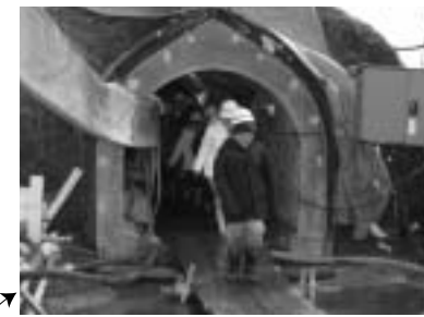
富田地区の農地への用水路「富田堰」のトンネルが完成し、2月8日トンネルの内覧会が行われ富長小学校の児童ら約30名が完成したばかりのトンネルを見学しました。
