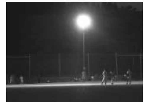
今春から舟形中学校にナイター照明設備を設置。
