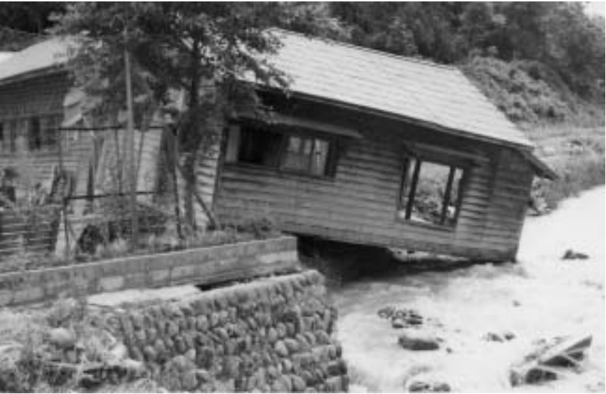
増水により土台が削り取られ、傾いた西又教職員宿舍（S 5 1.8.6）
